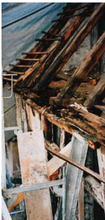
▲ Pinzenberg 20a: Maroder Zustand der Dachtraufe nach der Entfernung von Dachziegeln und losen Dachlatten.
