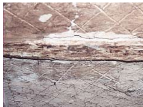
▲ Abb. 11 Raum 1.09. Ausschnitt mit Lehmdeckenfeldern. Die Balkenlage selbst stammt noch aus der „Speicherbau-Phase“. Charakteristisch für eine nachmittelalterliche Entstehungszeit sind die – in diesem Fall – schlichten Rauteneinritzungen. Sie hatten u.a. den Sinn, die Lehmflächen zu verdichten.
