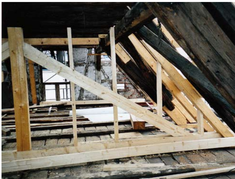
▲ Pinzenberg 20a: Aussteifung des Dachstuhls zur Stabilisierung der Konstruktion. Bei vorgerehenden Umbauten der Scheune wurden Sparrenteile ersatzlos herausgesägt, Stuhlrahm und Kehlbalken ziemlich
