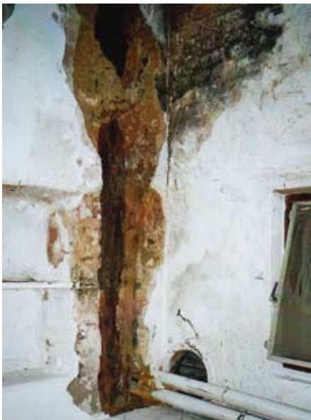
▲ Pinzenberg 20: Folgeschaden durch den oben gezeigten Wassereintrich: Eine der letzten originalen Stützen der ursprünglichen Fachwerkkonstruktion von 1493, durch Wassereintriff von oben durchfeuchtet und verfault.
