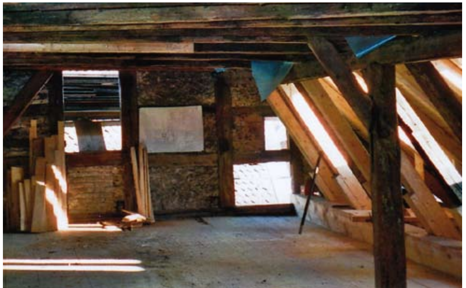
▲ Pinzenberg 20: Oben: Bei einem früheren Ausbau des Dachgeschosses angesetzte Balken ohne konstruktiv stabile Verbindung. Darunter: Blick in den Dachstuhl von West nach Ost, rechts wurde zur Stabilisierung ein Traufbalken wieder so eingefügt, wie er ursprünglich vor den Umbauten in der Barockzeit quer zum Ende der Zerrbalken eingebaut war.
