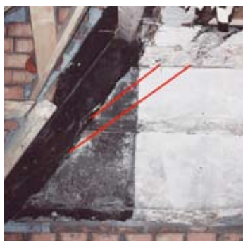
▲ Abb. 12 Raum 2.04 / Wand b. Vor dem Einbau der „neuen“ Lehmwand schnitt man den Zwischenbereich (rot markiert) des Stuhlbandes heraus. Wie man sieht, wurden anschließend die Lehmoberflächen wie der Dachstuhl mit der Bisterlasur eingelassen. Die nachfolgend beschriebenen, tatsächlich farbigen Anstriche blieben den „besseren“ Räumen der unteren Geschosse „vorbehalten“.
