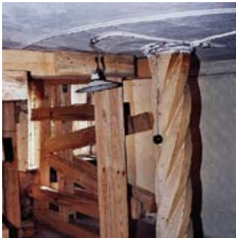
▲ Die nach Ansicht des Verfassers „eindruckvollste“ Einsturzsicherung musste in Raum 1.08 im Obergeschoss vorgenommen werden (Abb. 2).
