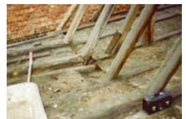
▲ Abb. 17 Zweites Dachgeschoss: Ausschnitt mit der Decken- bzw. Zerrbalkenlage der Aufstockung. Das barocke „Konzept“ erinnert frappierend an ein „Kamikazeunternehmen“, weil man offenbar allen Ernstes davon überzeugt war, das gotische Stuhlrahm könne eine „Doppelfunktion“ – sowohl als Auflager für die Kehlbalckenlage als auch als Unterzug der „neuen“ Zerrbalkenlage – übernehmen. Ohne jegliche Zugverbindungen oder zusätzlichen Stützen unter dem Rahm wurden die Balken seitlich (!) neben die gotischen Kehlbalcken aufgelegt (Aufnahme: Robert Rester).
