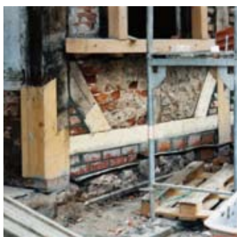
▲ Pinzenberg 18: Durch Feuchtigkeit zersetztes Holz des Fachwerks im Sockelbereich, Ersatz von schadhaften Teilen der Balkenkonstruktion.
