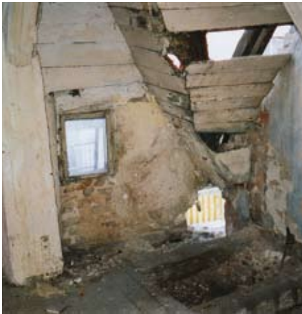
▲ Pinzenberg 20: Schaden im Dachgeschoss, verursacht durch Wassereintrich in die vorher schon beschädigte Dachhaut.
