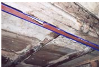
▲ Abb. 18 Raum 1.08, Deckenzone am Anschluss zur nördlichen Raumerweiterung: Die blauen Pfeile zeigen bauzeitliche Zerrbalken des Speicherbaudachstuhles, die gleichfarbigen Linien entlang des jetzt eingebauten Stahlträgers den Verlauf der in der Barockzeit abgebrochenen, spätgotischen Außenwand. Die Bretterbalkendecke (roter Pfeil) stammt aus der Zeit der Erweiterung. Die Zerrbalkenlage lag zur Bauzeit auf einem Rähmbalken und einer Fachwerkwand auf, wie kann man dann davon ausgehen, dass ein einzelner Deckenbalken die gleiche Funktion übernehmen könnte? Ebenso skurril: die beiden völlig grundverschiedenen Deckentypen – einerseits die Balkenlage mit dünn überputzten Lehmfeldern in den Zwischenräumen, andererseits die quer zu den Balkenverläufen eingebaute, eigentlich höher zu wertende Spunddecke – standen in dieser Form zueinander! Sie weisen sogar eine gemeinsame, barocke Erstfassung auf, nämlich einen mit Pflanzenschwarz gebrochenen Kalkanstrich. Die visuell feststellbare leichte Vergilbung des Anstriches geht nicht auf Pigmentzugaben zurück.
