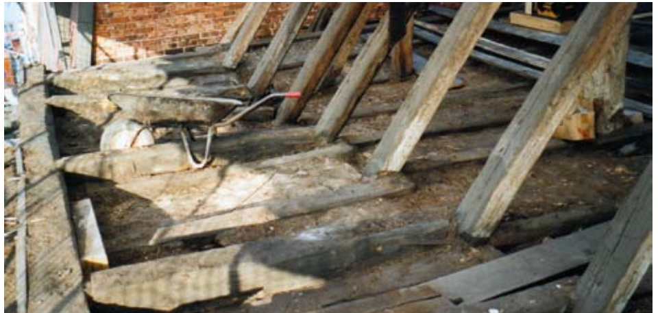
▲ Pinzenberg 20: Oben: Bei einer früheren Aufstockung des Dachgeschosses zur Barockzeit angesetzte Balken ohne konstruktiv stabile Verbindung. Der Traufbalken wurde nach außen versetzt.
