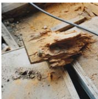
▲ Pinzenberg 18: Rest einer Verblattung mit Holznagel: Teilweise waren Holzbalken durch mangelhaften Schutz vor Niederschlägen vollständig zersetzt. Diese Elemente wurden vollständig ausgetauscht.
