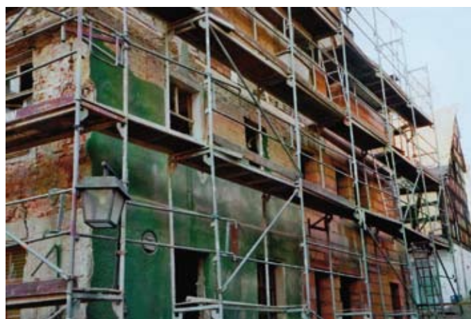
▲ Pinzenberg 20: Ostseite, bei der im Bereich hinter der Gaststube die gesamte Wand neu aufgemauert werden musste. Die Wand war stark nach außen verformt, viele Deckenbalken hatten aufgrund ungünstiger statischer Lasten durch die Dachkonstruktion eines Anbaus auf der Hofseite keine Verbindung zur Wand mehr.
