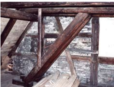
▲ Abb. 8 Dachstuhl, Ostseite. Eine der renaissancezeitlichen Änderungen betraf das mittelalterliche Walm-dach. Es wurde abgebrochen und durch diese (komplett gezapfte) Fachwerkkonstruktion ersetzt (1593/94 d). Für ein typisches Bearbeitungsmerkmal des damaligen Zimmermanns steht die Ausbildung des Lukensturzholzes in Form eines geschweiften sog. Eselsrückens.
